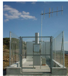
Un générateur automatique dans la province de Saragosse.
